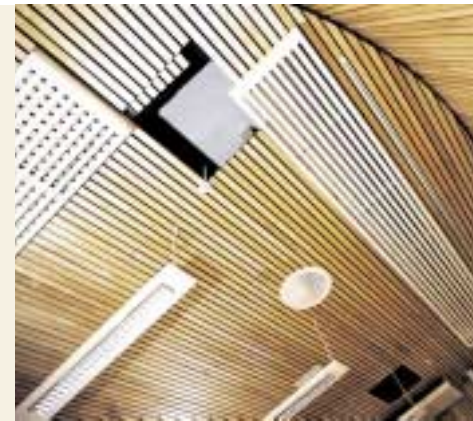
Den tradisjonelle radiatoren på veggen er erstattet av varme- og kjølebafler i taket.
